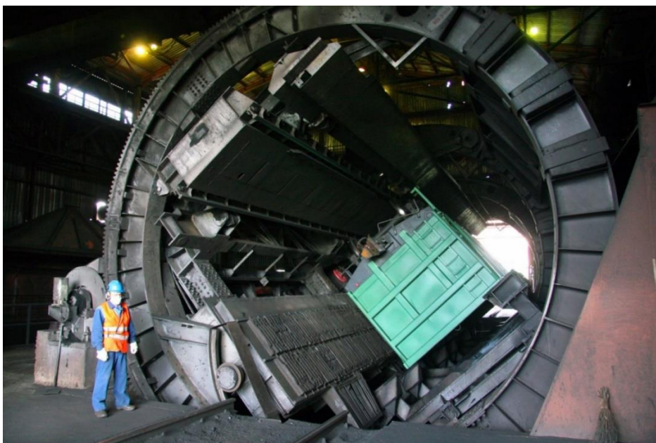
Рисунок 2.4 – Использование вагоноопрокидывателя для выгрузки угля
